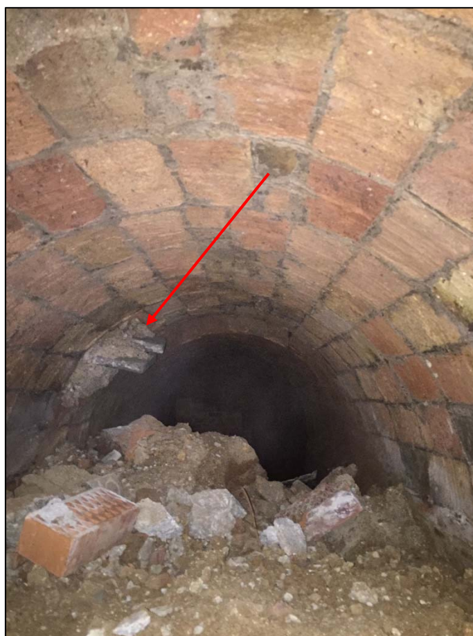
6. Espai intern del passadís d'entrada cobert de runa, afectació parcial de la volta per actuacions anteriors.
