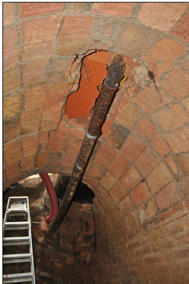
10. Afectació de la volta del passadís d'entrada per diversos serveis urbans.
