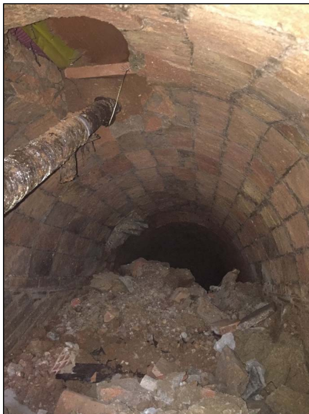
4. Afectació de la volta del refugi per servei elèctric, vista del rebliment de runa, estat inicial.
