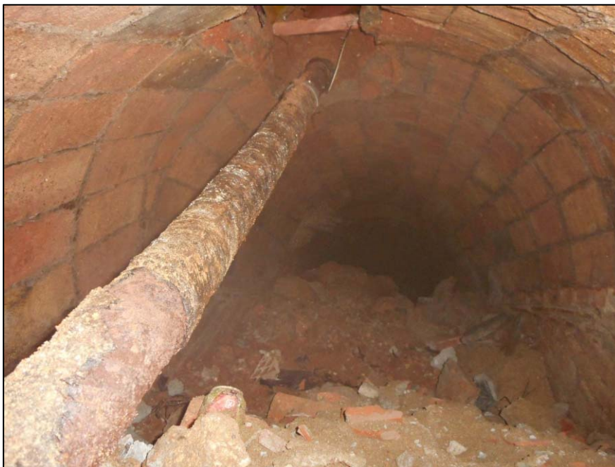
5. Afectació de la volta per servei elèctric contemporani.
