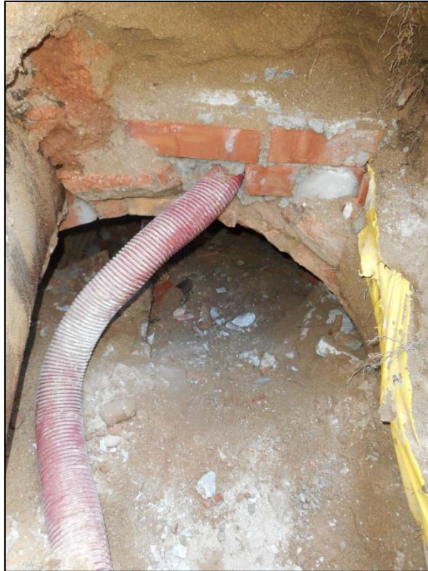
3. Detall de la volta afectada per servei urbà.
