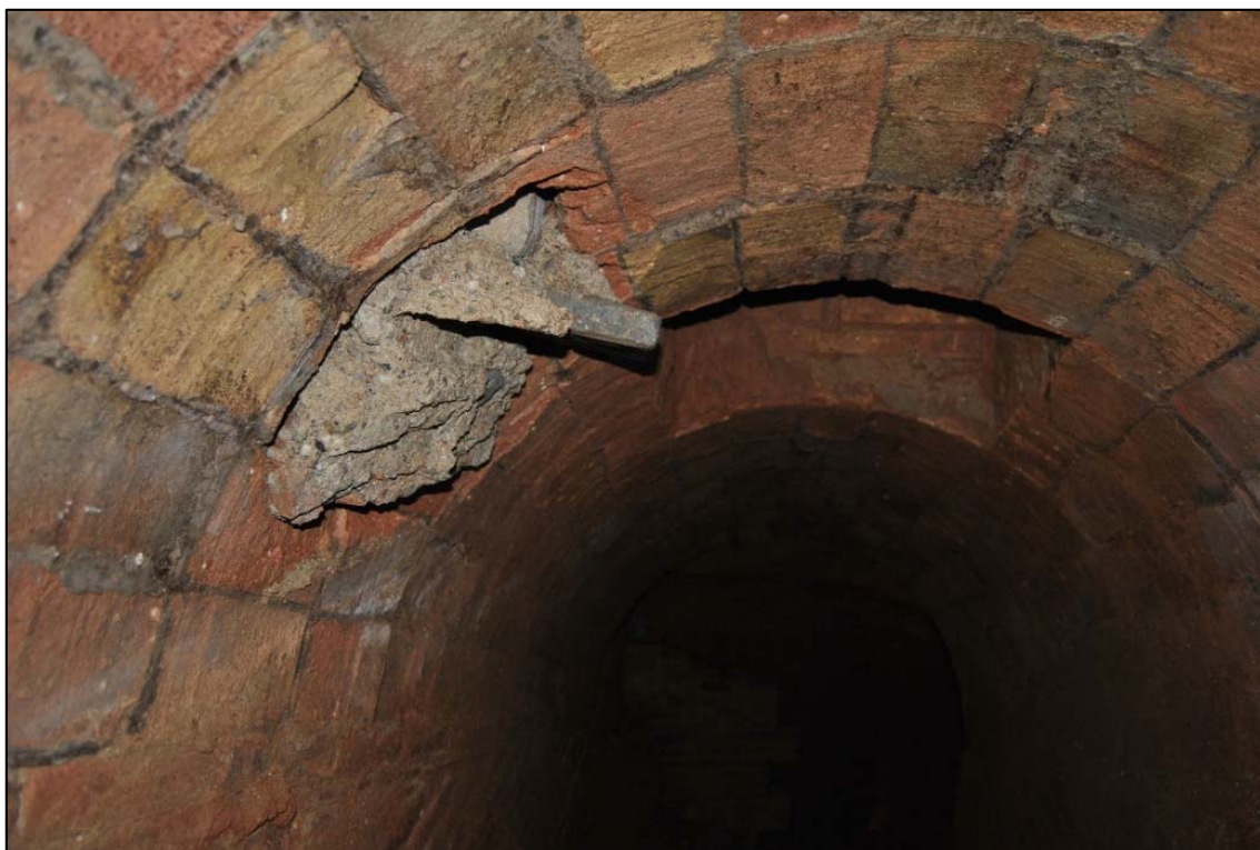
12. Afectació de l'estructura a l'alçada del primer respirall del passadís d'accés al refugi.
