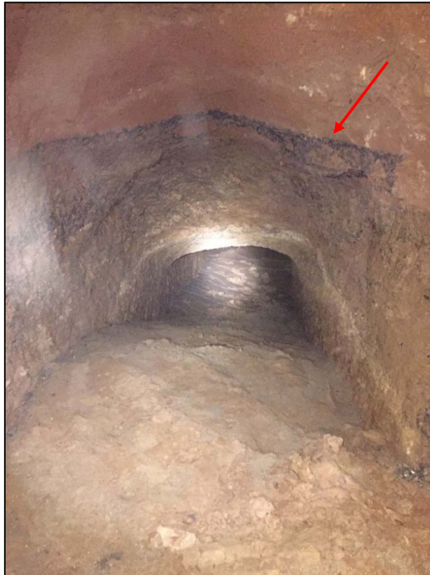
30. Localització del final del tram excavat de l'estructura. S'aprecia el nivell de residus fruit d'un moment d'inundació de l'estructura en aquest punt.
