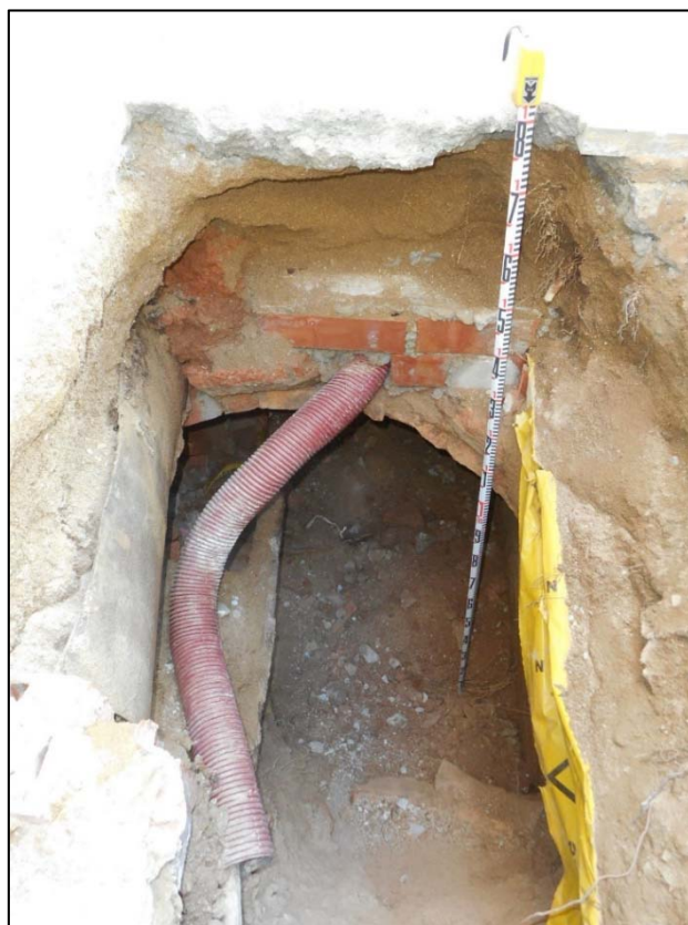
8. Inici dels treballs d'extracció de la runa des de la cala-obertura inicial.
