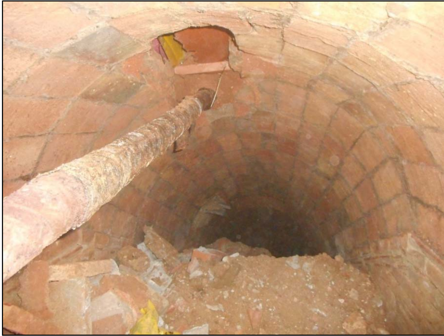
9. Afectació de la volta del refugi per servei elèctric, vista del rebliment de runa, estat inicial.
